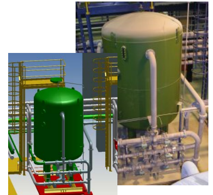
Eine Aktivkohle-Filteranlage im Kraftwerk Elbistan in der Türkei, zusammen mit dem MPDS-
