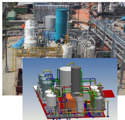
Eine Wasservorbehandlungsanlage mit Entmineralisierung in Trinidad, zusammen mit dem MPDS Originalmodell
