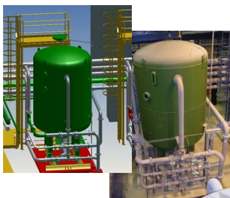
Un'unità di filtro a carboni attivi installata presso la centrale di produzione energetica di Elbistan (Turchia) e il relativo modello 3D in MPDS
