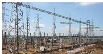
Eine typische Hochspannungsanlage
